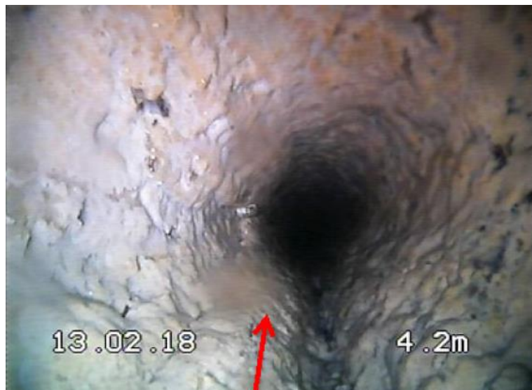
Starke Ablagerungen im Fallstrang einer Toilette
